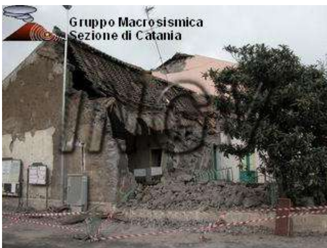
Foto 9. Bongiardo: crollo totale.
