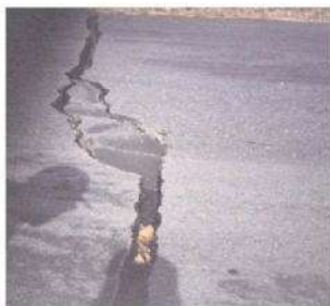
Foto 13: Particolare frattura lungo il cavalcavia (in corrispondenza del giunto di dilatazione).
