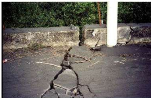
Foto 11: Particolare delle fratture di località Dagala Carne.
