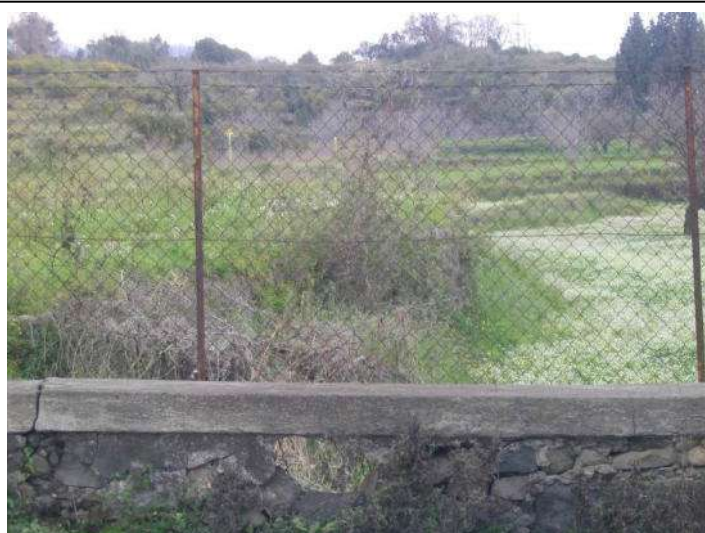
Foto 3.3.4.1.1 – Scarpata vergente ad Est associata alla frattura sul muro della strada (immagine del Gennaio 2005)
