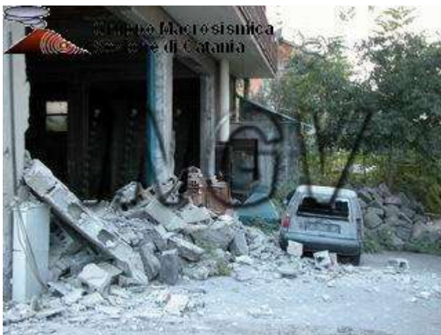
Foto 27. Felicetto (Linera): crollo di tramezzi in edifici in c.a.
