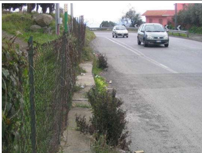
Foto 3.3.4.1.1 Evidenza di dislocazione verso Ovest e muro deformato (immagine del Gennaio 2005)
