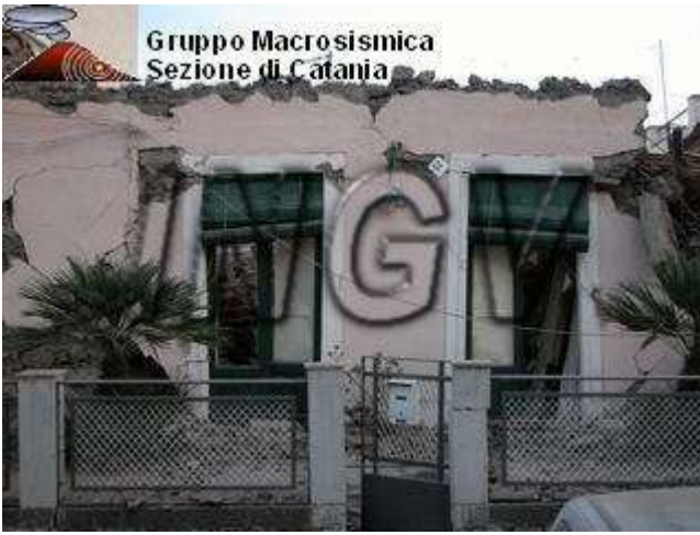
Foto 10. Scura (Guardia): crollo totale di un edificio in muratura.
