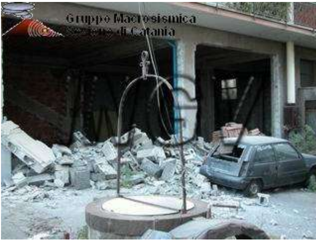
Foto 28. Felicetto (Linera): crollo di tramezzi in edifici in c.a.
