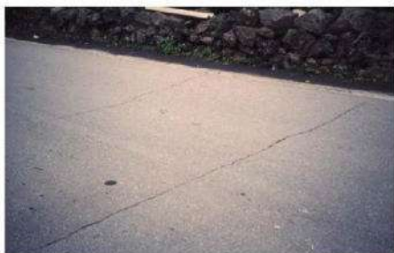
Foto 13: Fratture lungo il tratto orientale di via Felicetto.
