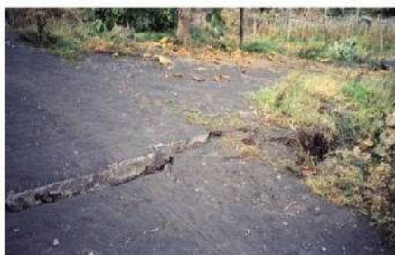
Foto 14: Frattura con dislocazione e apertura lungo una strada interpodereale a Orvest di via Senca.
